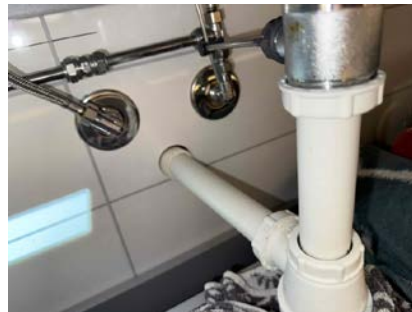
Bildet viser avløpsrøret til servanten med utette gjennomføring.
