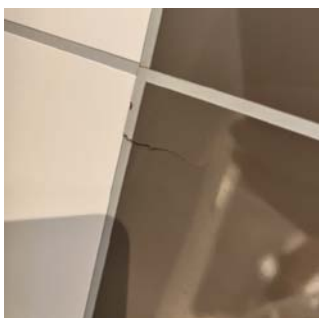
Bildet viser plate med en liten skade.
