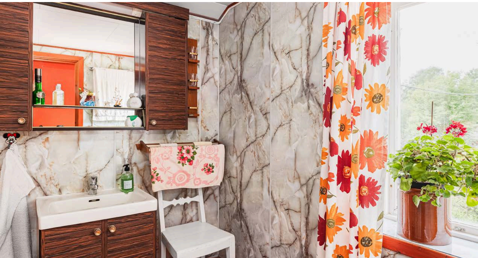
I boligens 2. etasje er det et eldre baderom med belegg på gulv og våtromsplater på veggene. Baderommet har fått TG3 i tilstandsrapporten og har behov for oppussing.
