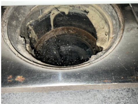
Sluk i gulvet for lekkasjevann.
