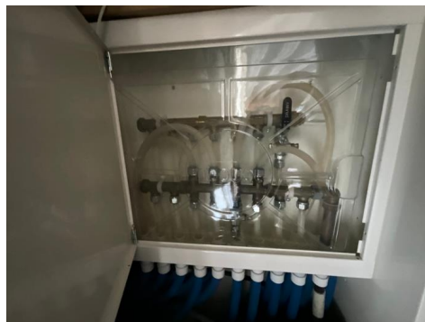
Rør i rør skap for boligen.
