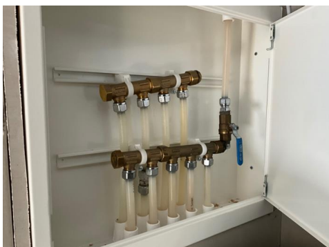
Rør i rør skap for hybelen.
