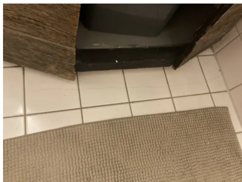
Gjennomgående sprekk i gulvfliser.
