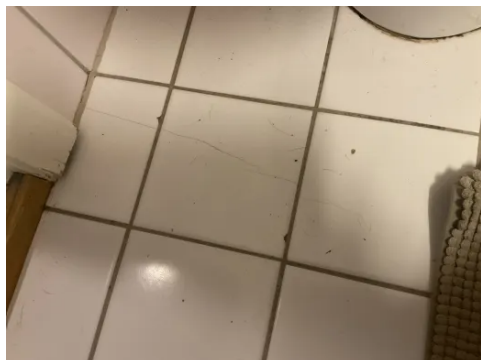
Sprekk i gulv.
