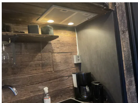
Avtrekksvifte er funksjonstestet med papir. Komfyrvakt er montert.
