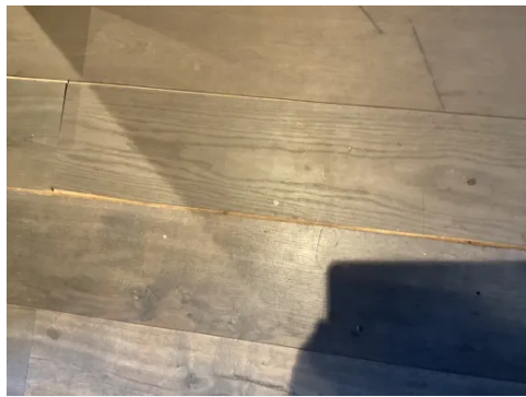
Skade i gulv.
