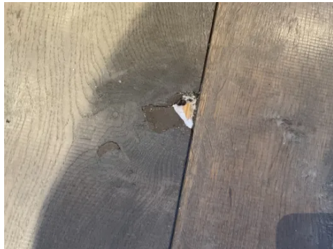
Skade i gulv.
