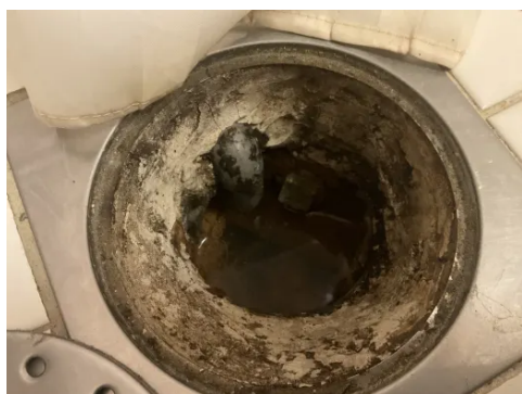
Ikke synlig mansjett i klemring.
