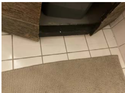
Gjennomgående sprekk i gulvfliser.
