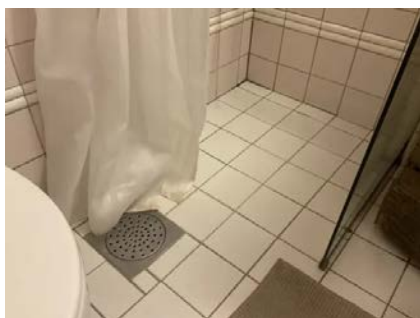
Gjennomgående sprekk i gulv.
