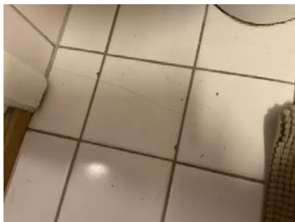
Sprekk i gulv.
