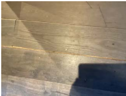
Skade i gulv.
