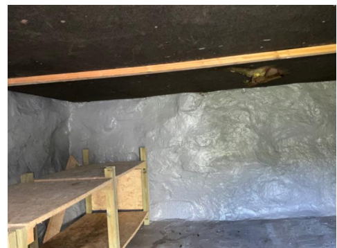
Hull i stubbeloftsplate i krypkjelleren. Anbefales å skifte ut skadet området.
