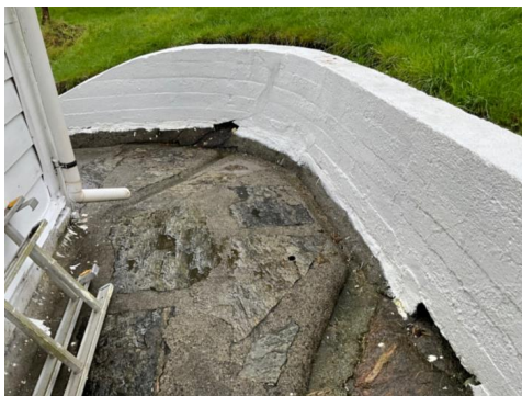
Forstøtningsmur ved hovedinngang mangler rekkverk.
