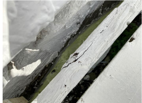
Råteskader i bjelkelag; eks. Bjelke inn mot yttervegg.
