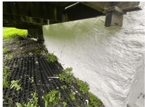
Grunnmur under altan/ terrasse. Noen riss/ sprekker.
