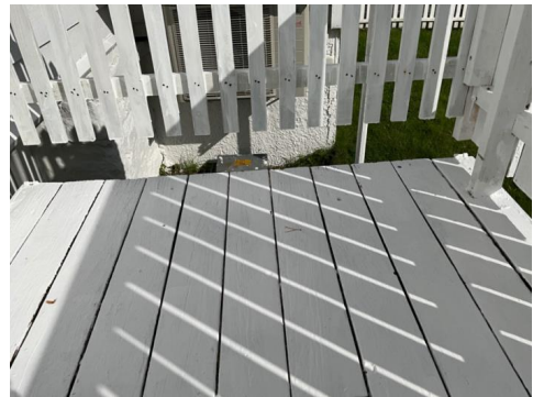
På målt sted (stikkmål) var det 13 cm, mellom terrassedekke og rekkverk.
