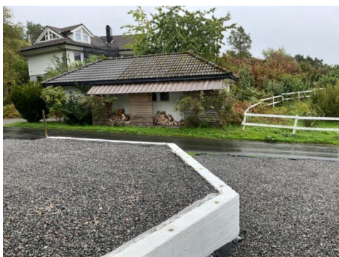
Forstøtningsmur ved biloppstillingsplass mangler rekkverk.
