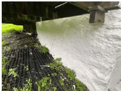
Grunnmur under altan/ terrasse. Noen riss/ sprekker.
