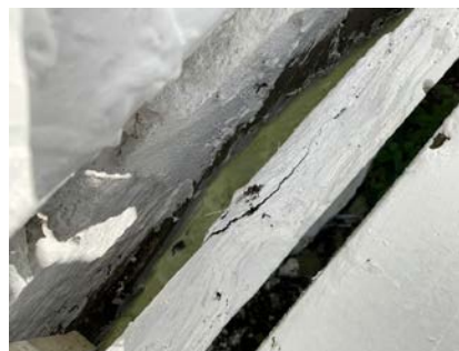
Råteskader i bjelkelag; eks. Bjelke inn mot yttervegg.
