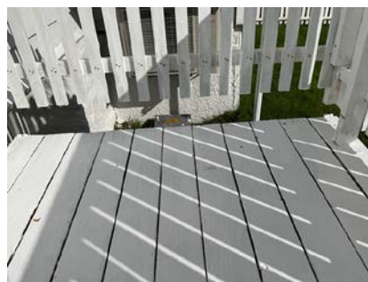
På målt sted (stikksmål) var det 13 cm, mellom terrassedekke og rekkverk.
