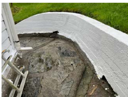
Forstøtningsmur ved hovedinngang mangler rekkverk.
