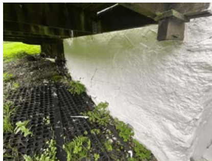
Grunnmur under altan/ terrasse. Noen riss/ sprekker.
