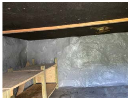
Hull i stubbloftsplate i krypkjelleren. Anbefales å skifte ut skadet området.
