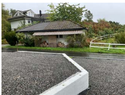
Forstøtningsmur ved biloppstillingsplass mangler rekkverk.
