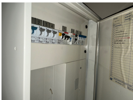
Automatsikringer i sikringsskap plassert i hall m/entré.
