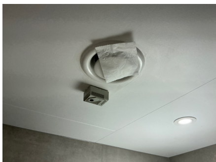
Kontroll av avtrekk.
