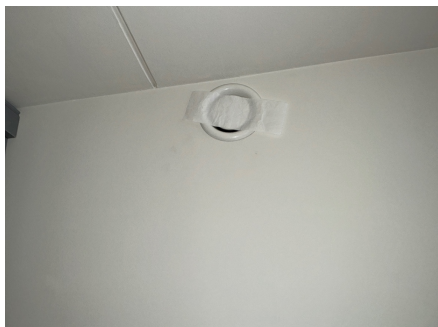
Kontroll av avtrekk.
