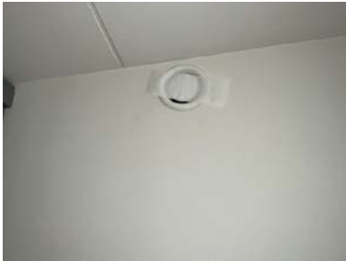
Kontroll av avtrekk.
