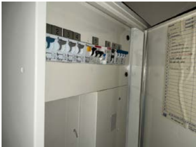
Automatsikringer i sikringsskap plassert i hall m/entré.
