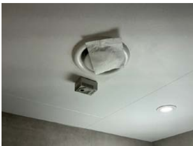
Kontroll av avtrekk.
