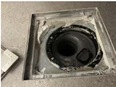
Kontroll av sluk under servant.
