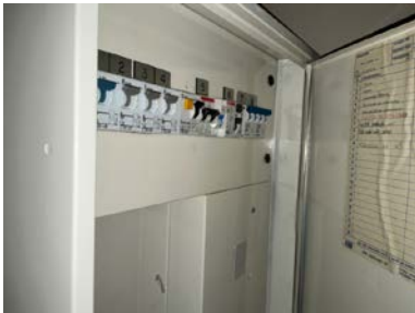
Automatsikringer i sikringsskap plassert i hall m/entré.
