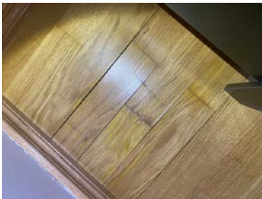
Sprekker i skjøter på laminat.
