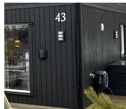
Easee ladestasjon på yttervegg.
