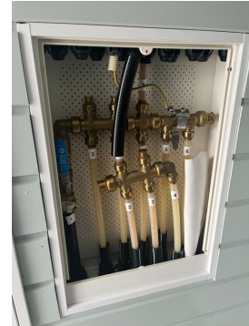
Fordelerskap med stoppekran.
