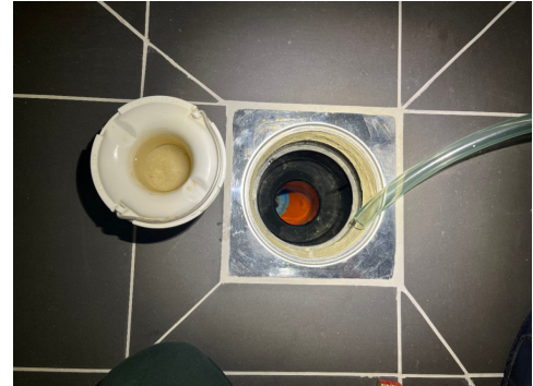
Sluk i dusjsone.
