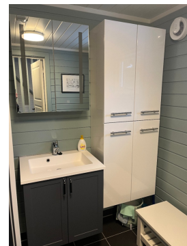
Våtzone til servant er ikke vanntett.
