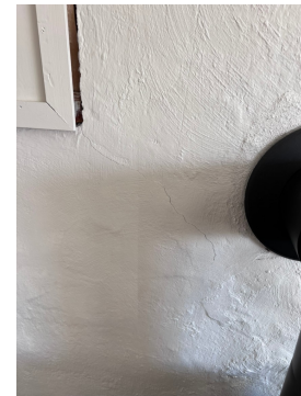
Registrert sprekk i pipe, ansees som setning
