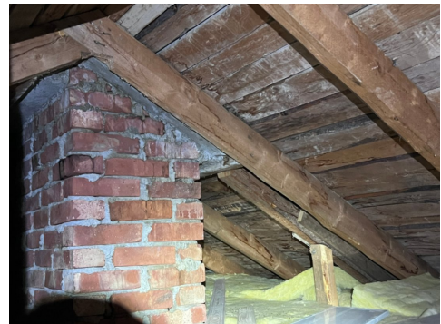
Registrert fuktskjolder langs sperrer og undertak, spesielt fra pipestamme der tiltak over tak er forbedret med pipebeslag
