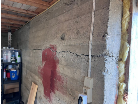
Sprekker og deformasjoner på mur
