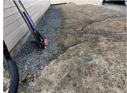
Ikke tilstrekkelig terrengfall mot mur
