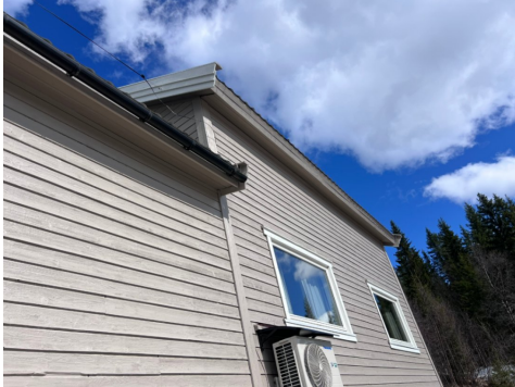
Manglende takrenne og forantbord på nedsiden
