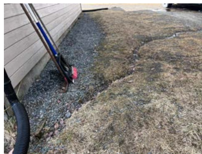
Ikke tilstrekkelig terrengfall mot mur
