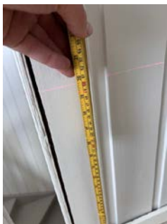
Målt planavvik med laser, målt høyde på 49 cm utofra laser
