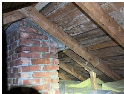
Registrert fuktskjolder langs sperrer og undertak, spesielt fra pipestamme der tiltak over tak er forbedret med pipebeslag
