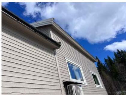
Manglende takrenne og forantbord på nedsiden
