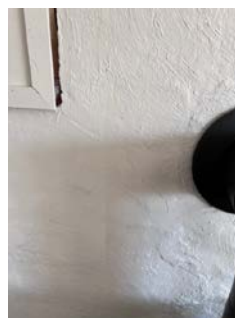
Registrert sprekk i pipe, ansees som setning
