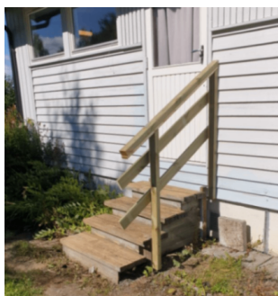
Bilde av rekkverk er ettersendt av eier.
