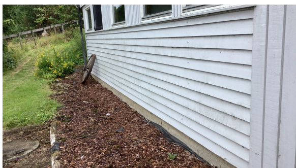
Vedlikeholdsbehov på utvendig kledning.
