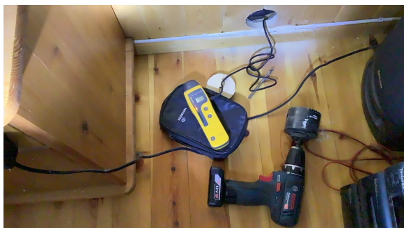
Det ble registrert forhøyede verdier av fukt i trekonstruksjon bak plast.
