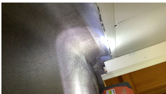
Belegg er kun lagt opp mot veggplater.
