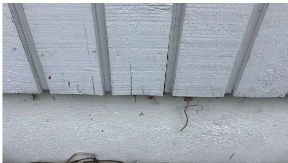
Vedlikeholdsbehov på utvendig kledning.
