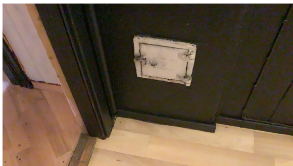
Feieluken er for nærmere brennbart. Kravet er 30 cm.
