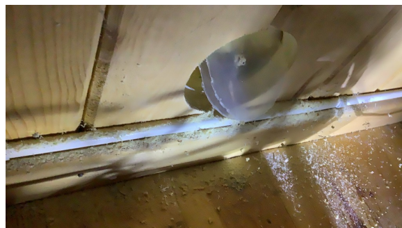
Det er registrert plast i vegg.
