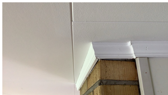
Pipe/forblending er skjevt murt gjennom etasjeskiller. Avviket er kun visuelt.
