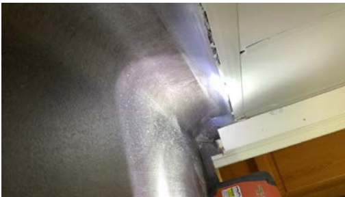
Belegg er kun lagt opp mot veggplater.
