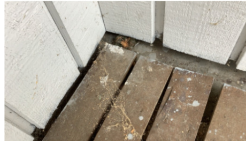
Tekking av gulv er fra byggeåret på balkong i 1. etasje.
