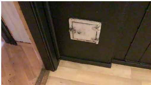
Feieluken er for nærme brennbart. Kravet er 30 cm.
