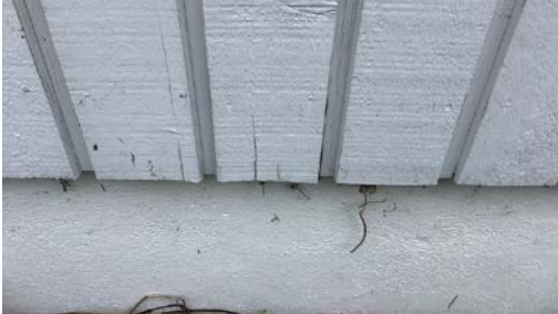
Vedlikeholdsbehov på utvendig kledning.
