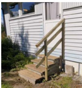
Bilde av rekkverk er ettersendt av eier.
