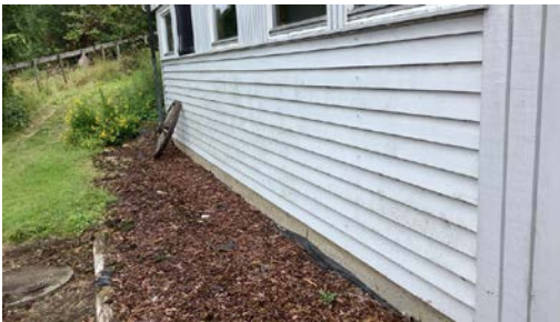
Vedlikeholdsbehov på utvendig kledning.
