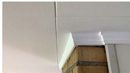
Pipe/forblending er skjevt murt gjennom etasjeskiller. Avviket er kun visuelt.
