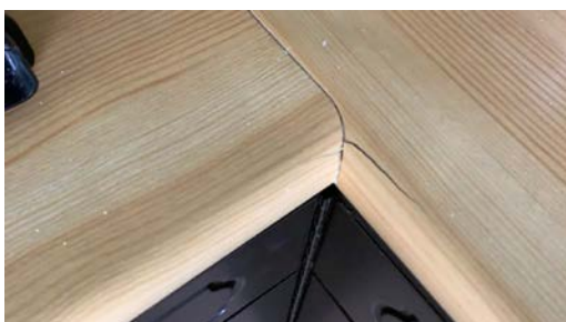
Det er skade i folien på benkeplate.
