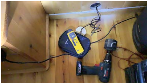
Det ble registrert forhøye verdier av fukt i trekonstruksjon bak plast.
