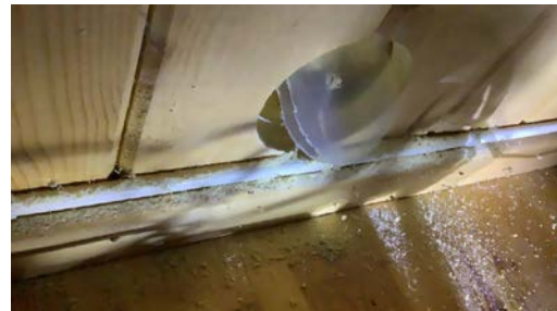
Det er registrert plast i vegg.
