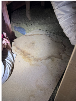
Eldre fuktmerke på sponplate (gulv)
