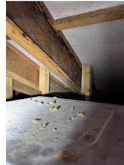
Soppdannelse på takspærre under befaring
