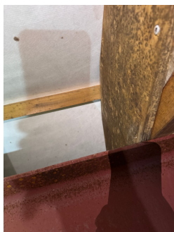
Soppdannelse på takspærre under befaring
