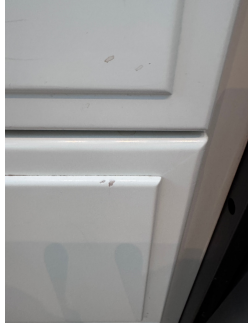
Enkelte småskader/hakk i innredningen
