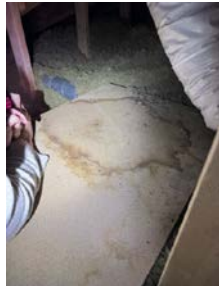
Eldre fuktmerke på sponplate (gulv)
