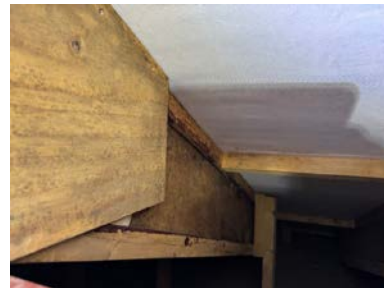
Boligeiere har i etterkant av undertegnedesbefaring vasket trevirket med klor.
