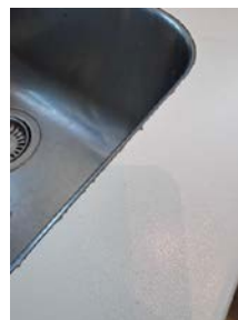
Enkelte småskader/hakk i benkeplaten
