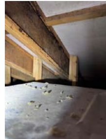
Soppdannelse på takspærre under befaring
