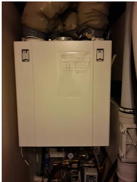
Ventilasjonsaggregat er plassert i bod/teknisk rom.
