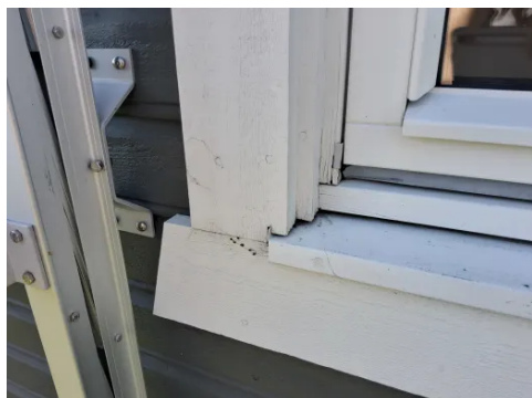
Vinduer i gavlvegg er værslitt.
