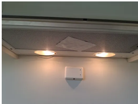
Avtrekkseffekt er testet med papir.
