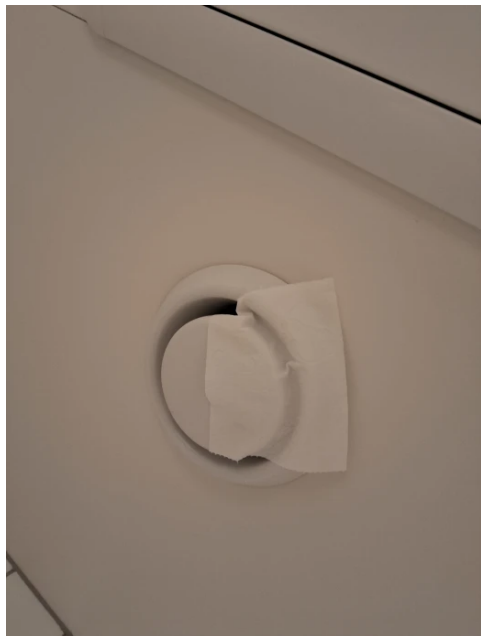
Avtrekkseffekt er testet med papir.
