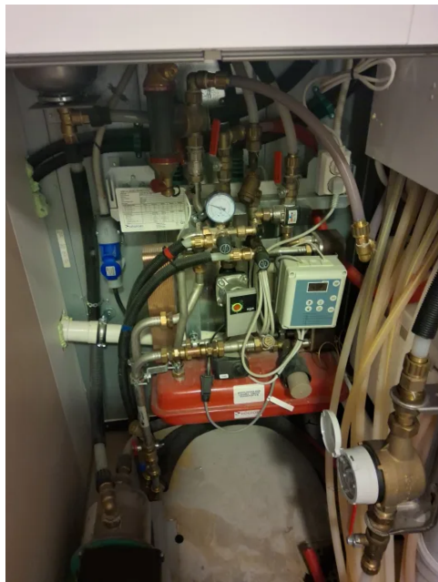
Fjernvarmesentral er plassert i bod/teknisk rom.
