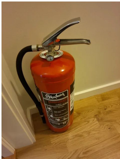
Brannslukningsapparat er plassert i bod/teknisk rom.
