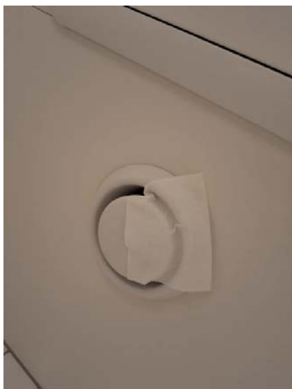
Avtrekkseffekt er testet med papir.
