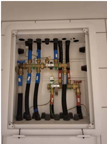
Fordelerskap for rør-i-rør med stoppekraner er plassert på bad.
