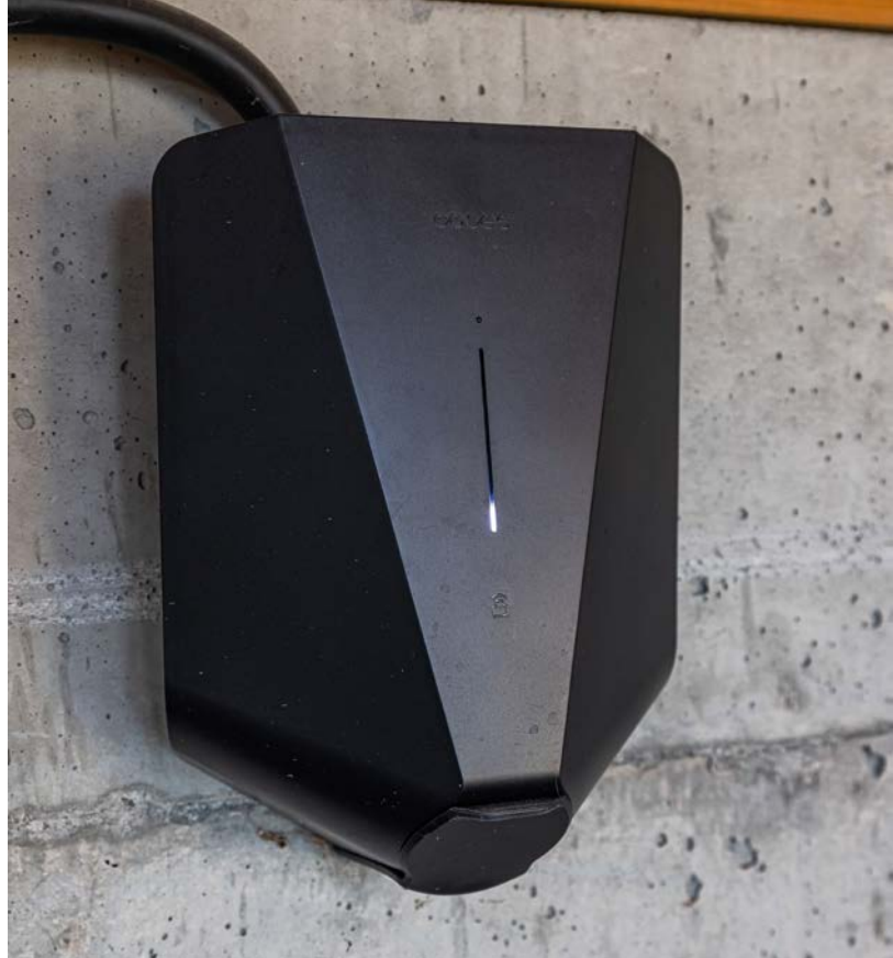
Det er montert elbil-lader i carporten.
