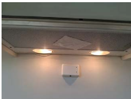
Avtrekkseffekt er testet med papir.
