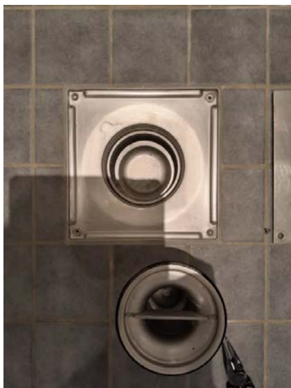
Sluk i rustfritt stål.
