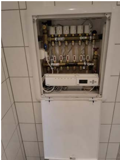
Gulvvarmesentral er plassert i fordelerskap på bad.
