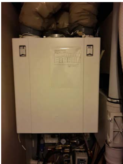
Ventilasjonsaggregat er plassert i bod/teknisk rom.
