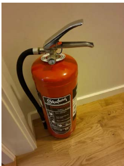
Brannslukningsapparat er plassert i bod/teknisk rom.
