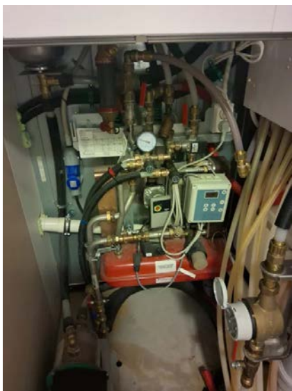
Fjernvarmesentral er plassert i bod/teknisk rom.
