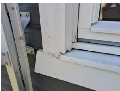
Vinduer i gavivegg er værslitt.
