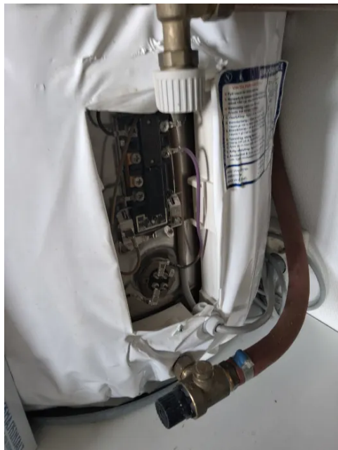
Deksel over elektriske koblinger på berederen er defekt.
