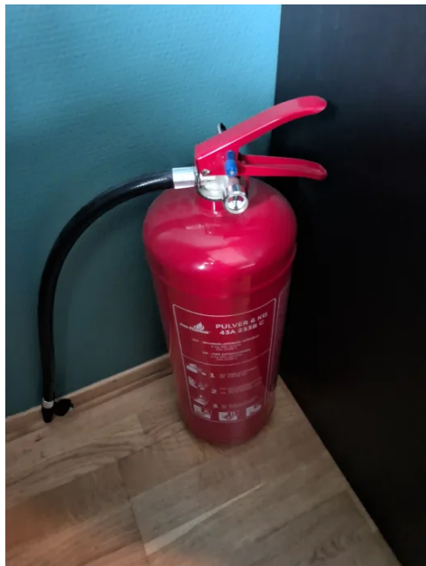
Brannslukningsapparat er plassert på soverom.
