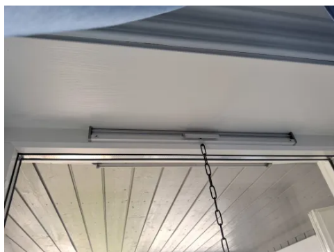
Leiligheten har naturlig tilluft fra spalteventiler i vinduer.
