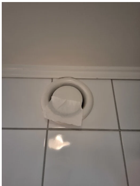
Avtrekkseffekten er testet med papir.
