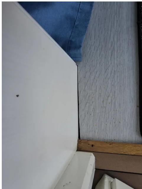
Bilde viser glippe mellom klikkvinyll og døråpning til balkongdør.
