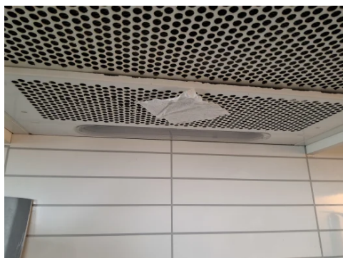
Avtrekkseffekt er testet med papir.
