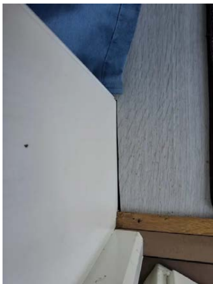
Bilde viser glipe mellom klikkvinyll og døråpning til balkongdør.
