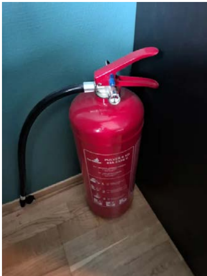
Brannslukningsapparat er plassert på soverom.
