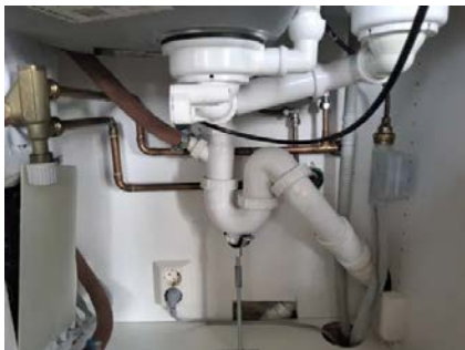
Synlige avløpsrør av plast.
