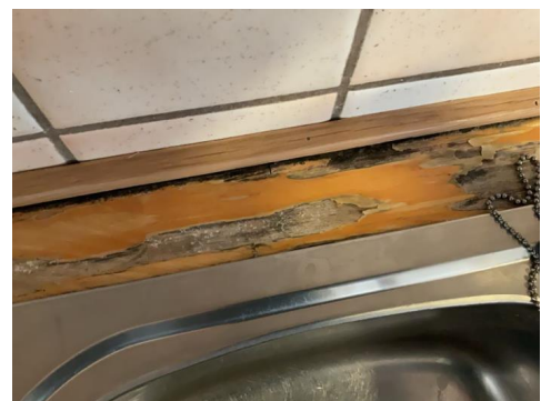
Fuktskade i benkeplate
