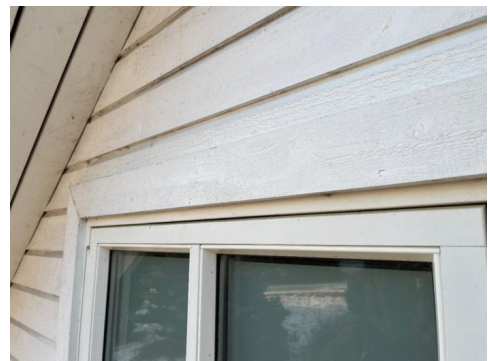
Manglende vannbrett/beslag over vinduer.
