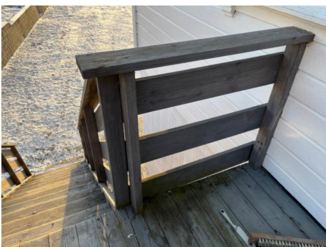
Lavt rekkverk, store åpninger.
