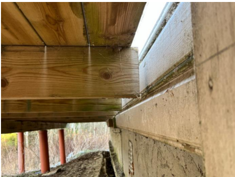
Manglende bjelke/innfesting mot boligen
