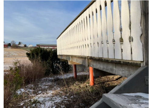
Synlig skjevhet i terrasse
