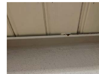
Synlig drypp/vann ved pipe
