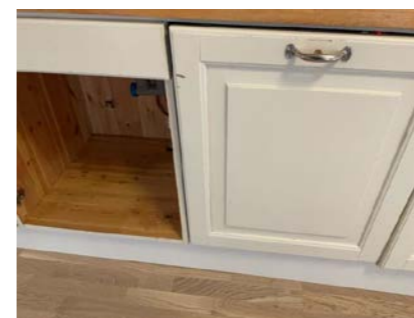
Slitasje på fronter.
