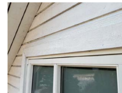
Manglende vannbrett/beslag over vinduer.
