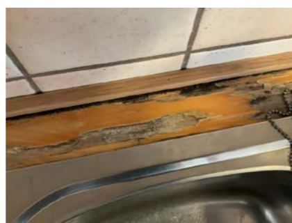
Fuktskade i benkeplate
