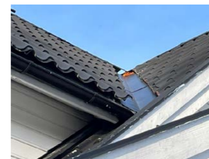
Rust på plater. Ufagmessig tetting mot møne.
