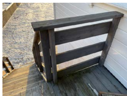
Lavt rekkverk, store åpninger.
