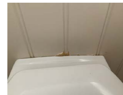
Fuktskade i vegg.
