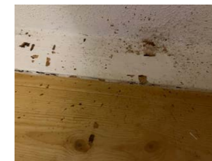
Vann ved pipe.
