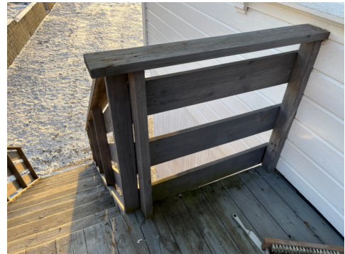
Lavt rekkverk, store åpninger.
