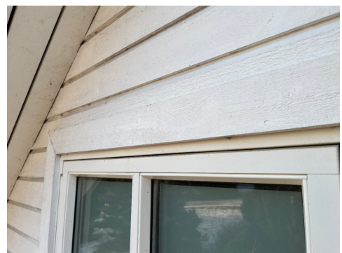
Manglende vannbrett/beslag over vinduer.
