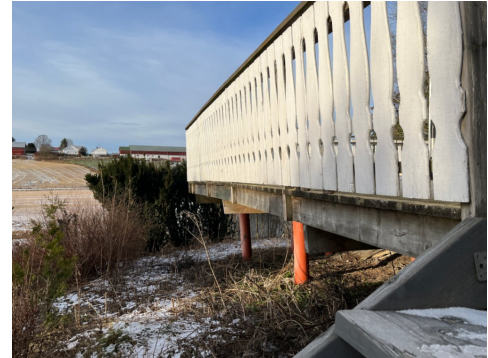
Synlig skjevhet i terrasse
