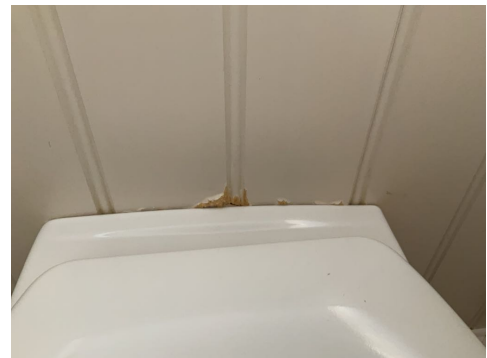
Fuktskade i vegg.
