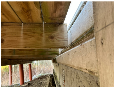
Manglende bjelke/innfesting mot boligen
