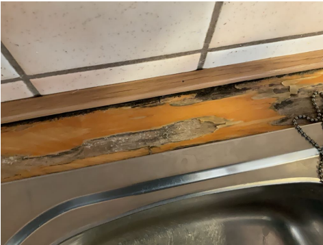
Fuktskade i benkeplate
