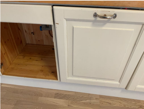
Slitasje på fronter.
