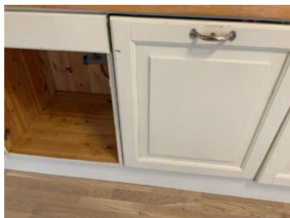
Slitasje på fronter.
