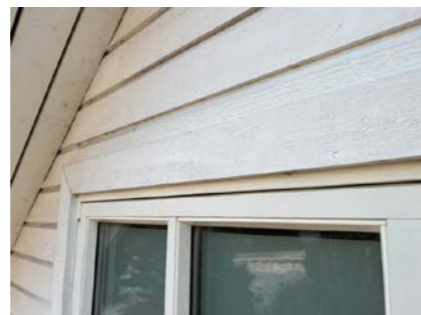
Manglende vannbrett/bslag over vinduer.
