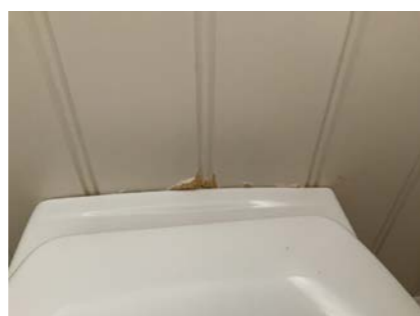
Fuktskade i vegg.
