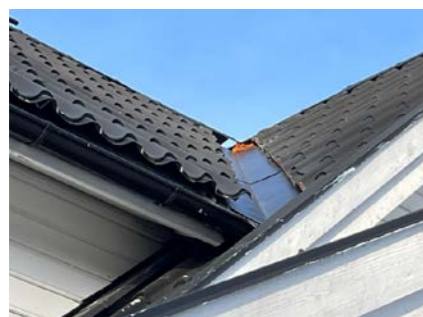
Rust på plater. Ufagmessig tetting mot møne.
