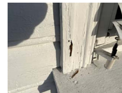
Råteskade i listverk. Manglende beslag.
