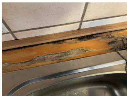
Fuktskade i benkeplate
