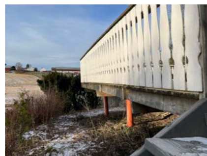
Synlig skjevhet i terrasse
