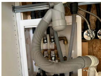
Manglende stoppekran i leilighet
