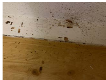
Vann ved pipe.
