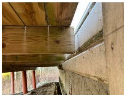
Manglende bjelke/innfesting mot boligen
