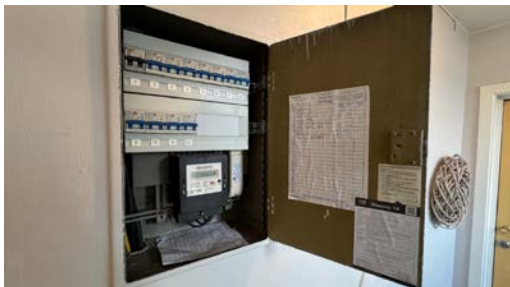
Kontroll av el-skap og kursfortegnelse.
