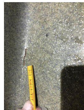
Bilde av sprekk i gulvbelegg i dusjonene.
