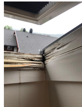
Bilde av råteskader på takvindu
