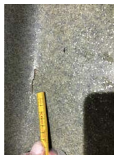
Bilde av sprekke i gulvbelegg i dusjsonene.
