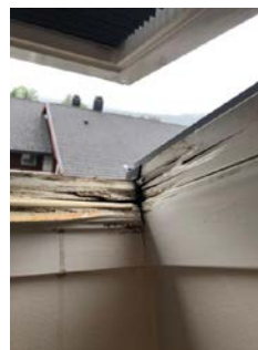
Bilde av råteskader på takvindu
