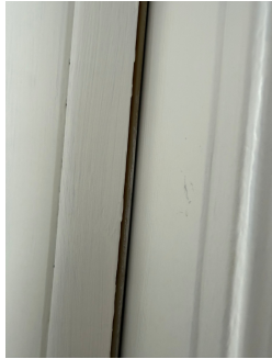
Synlig utetthet mellom dørblad og karm på balkongdør.
