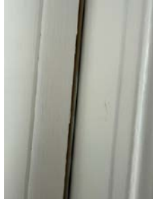
Synlig utetthet mellom dørblad og karm på balkongdør.
