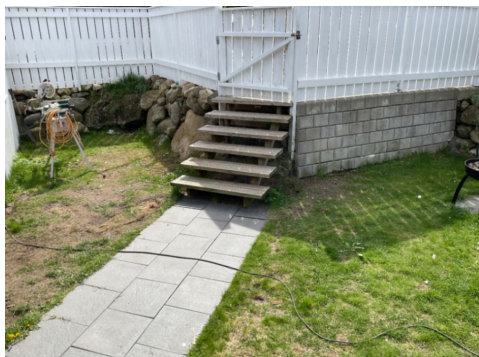
Trapp uten rekkverk
