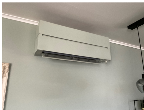
Varmepumpe i stuen
