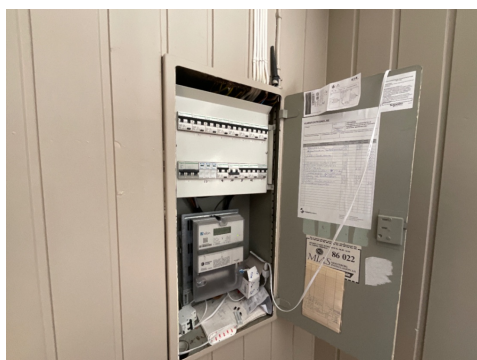
Sikringsskap i kjelleren
