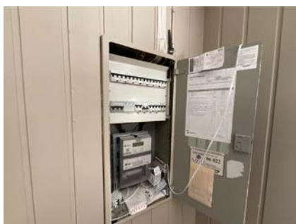
Sikringsskap i kjelleren
