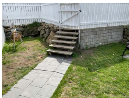
Trapp uten rekkverk
