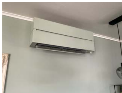
Varmepumpe i stuen
