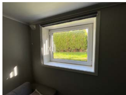
Pvc vindu i kjeller
