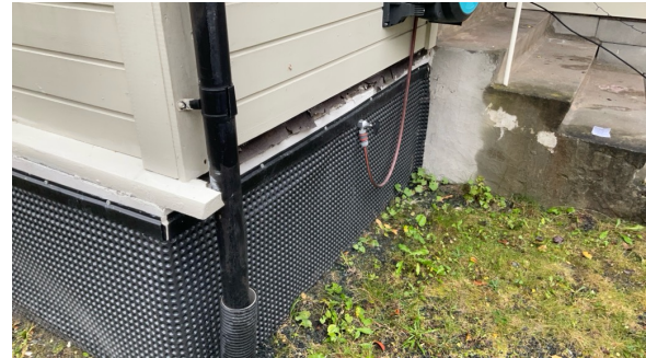
Noe uferdig avslutning mot grunnmur.
