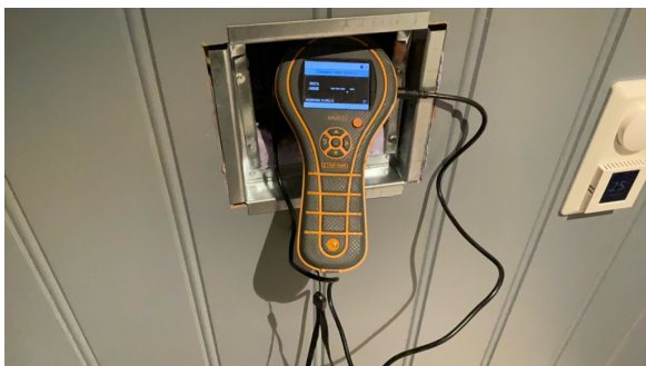
Fuktmåling med pigger i treverk.
