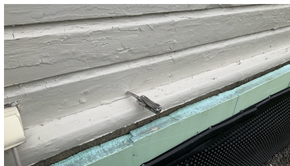
Råte i kledning.
