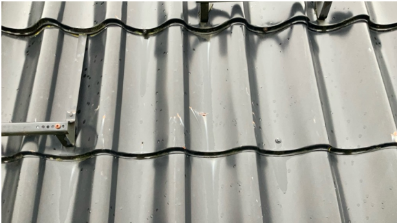
Rust og knatt i takplater.
