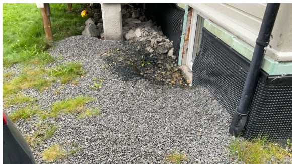
Fall på terreng mot kjellervinduer.
