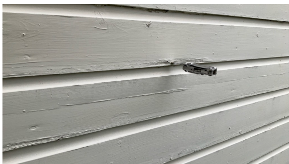
Råte i kledning.
