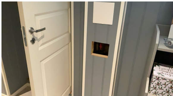
Stoppekran bak luke i kontor i kjelleren
