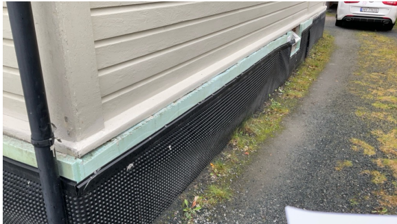
Grunnmursplast avsluttet langt over terreng.
