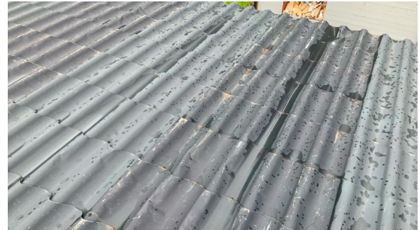
Rust og bulker i takplater.
