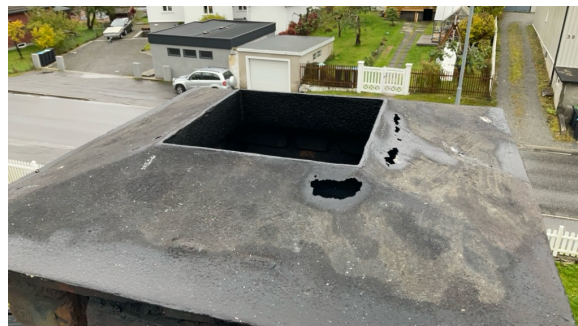
Hull i topphatt på pipen
