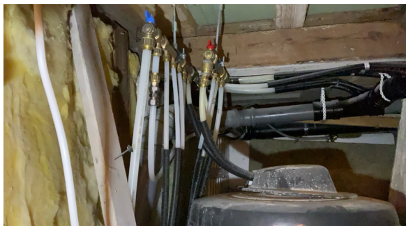
Rørapplegg i bod innenfor bad/vaskerom.
