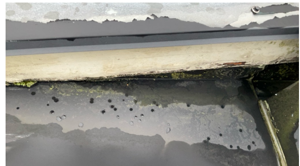
Råte i vindskier.
