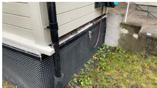
Noe uferdig avslutning mot grunnmur.
