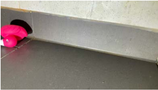
Det mangler bunnlist og Silicon i nedre kant av våtromsplater.
