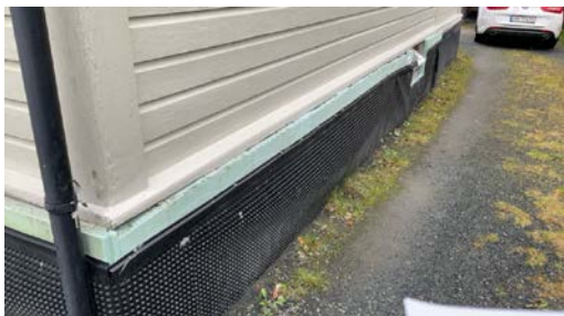
Grunnmursplast avsluttet langt over terreng.
