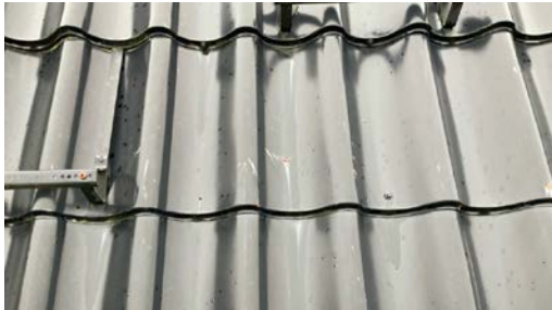
Rust og knatt i takplater.
