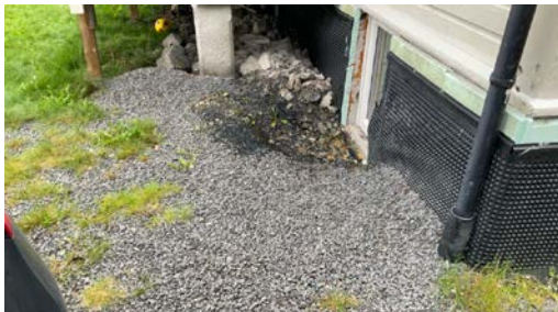
Fall på terreng mot kjellervinduer.
