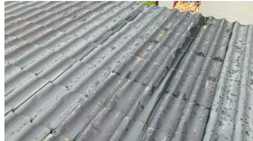
Rust og bulker i takplater.
