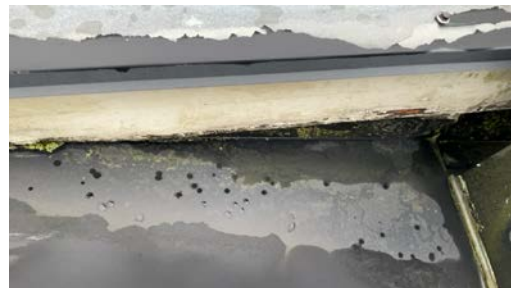
Råte i vindskier.
