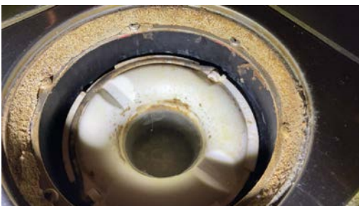
Plastsluk i dusjsonen.
