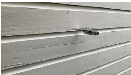
Råte i kledning.
