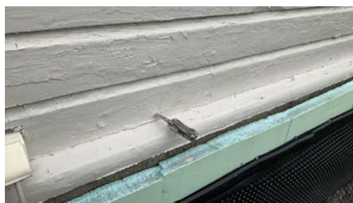
Råte i kledning.
