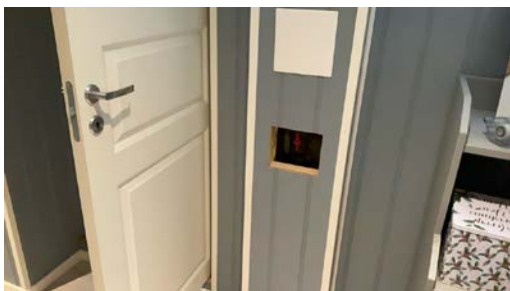
Stoppekran bak luke i kontor i kjelleren
