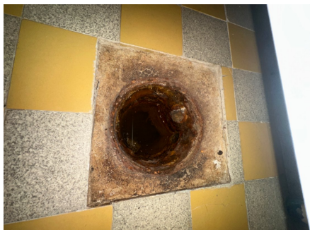
Sluk i soil på bad i 2.etg
