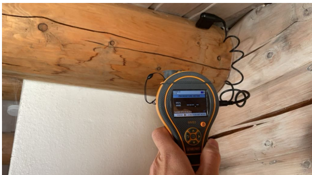
Fuktskjolder i ås ved himling pipestamme, ved fuktmåletaking var det ikke fuktutslag og bør holdes under tilsyn
