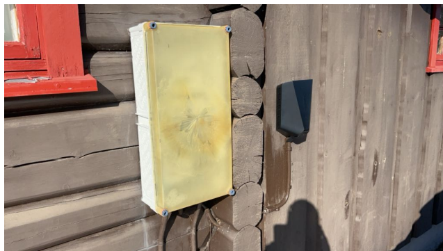
Utvendig skap og elbil lader
