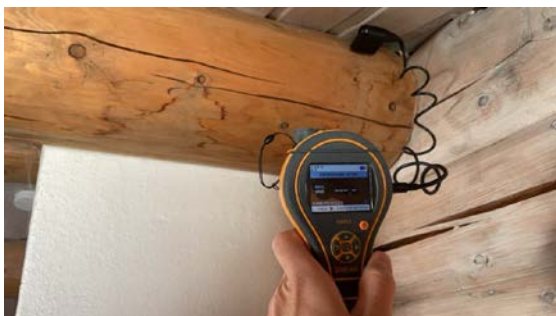
Fuktskjolder i ås ved himling pipestamme, ved fuktmåletaking var det ikke fuktutslag og bør holdes under tilsyn
