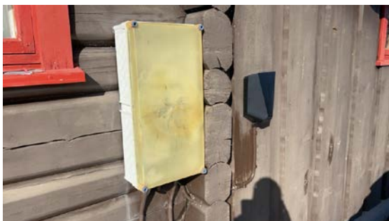
Utvendig skap og elbil lader
