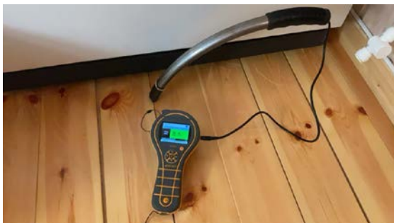
Ved fuktmåletaking av gulv ved tank var det ikke utslag
