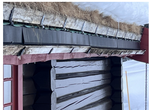
Lekkasjer på takrenner og skjevheter i overgang skjøt
