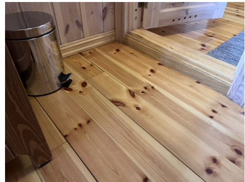
Manglende tettesjikt i rom for å ansees som et våtrom
