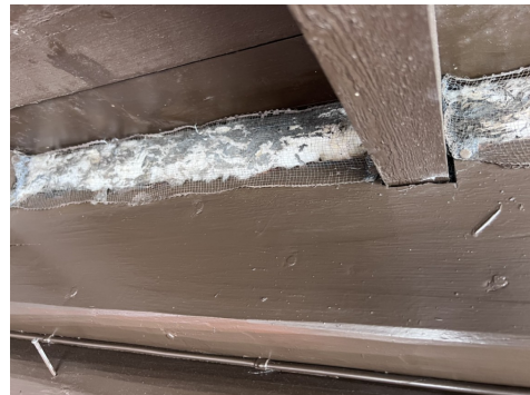
Begrenset lufting, og manglende dekkbord mot isolasjon
