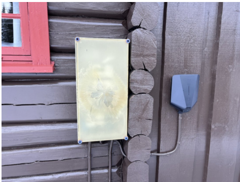
Utvendig skap og elbillader
