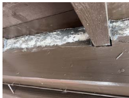
Begrenset lufting, og manglende dekkbord mot isolasjon
