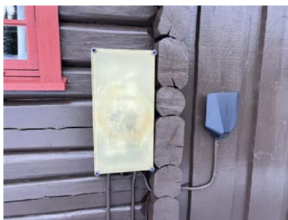
Utvendig skap og elbillader
