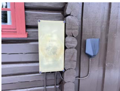
Utvendig skap og elbillader
