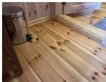
Manglende tettesjikt i rom for å ansees som et våtrom
