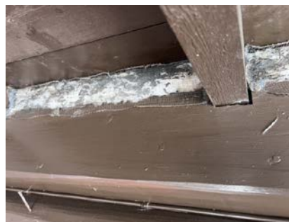
Begrenset lufting, og manglende dekkbord mot isolasjon
