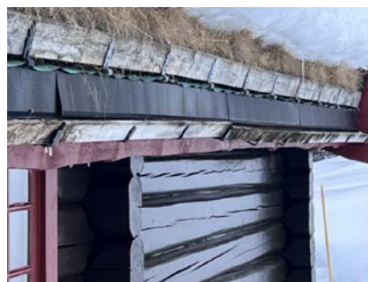
Lekkasjer på takrenner og skjevheter i overgang skjøt
