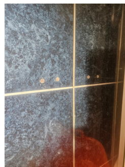
Hull etter gammel innredning på vegg.
