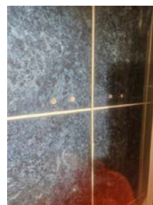
Hull etter gammel innredning på vegg.
