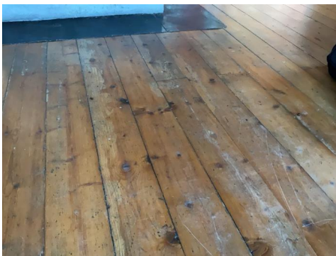
Slitasje på overflater
