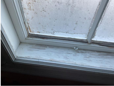
Vinduer er preget av elde
