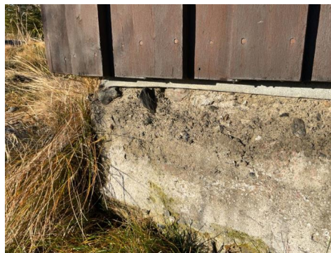
Forvitring av mur
