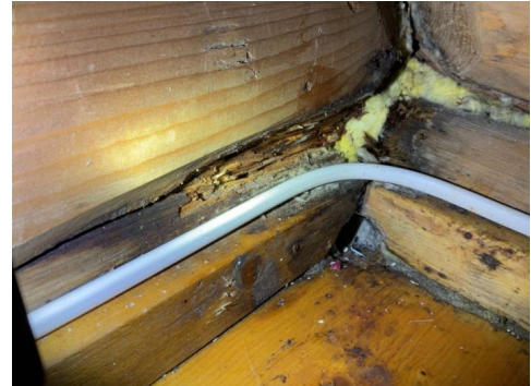
Råte i veggkonstruksjon
