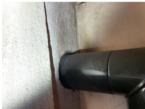
Sot utifra røykrør fra vedovn, trolig utetthet i overgang
