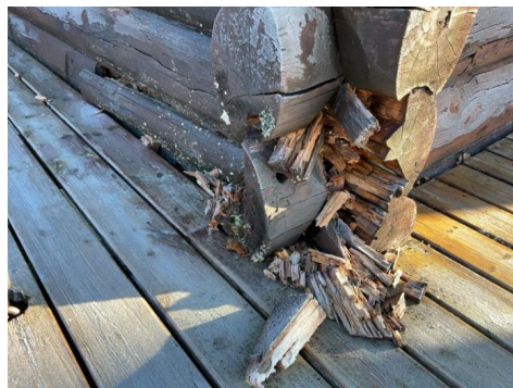
Råteskader i veggkonstruksjon
