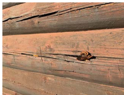
Sopp i veggkonstruksjon, der store deler av veggkonstruksjonen må skifte
