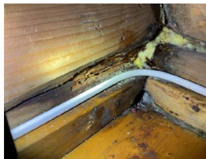
Råte i veggkonstruksjon
