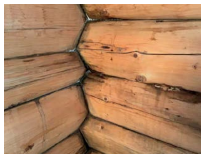
Råte og muggsopp i veggkonstruksjon
