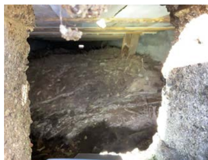
Behrenset inspeksjon av kryprom, kun via ventil i mur. Bemerket fuktig miljø der stedvis stubbeloft har falt ned
