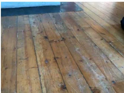
Slitasje på overflater
