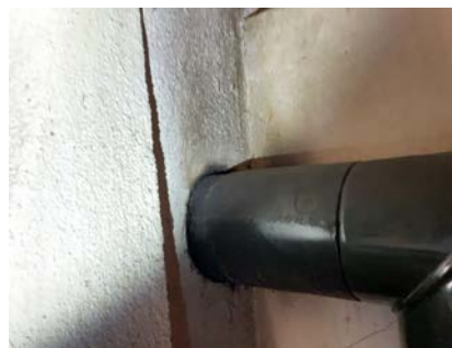
Sot utifra røykrør fra vedovn, trolig utetthet i overgang
