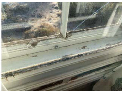
Sprekke i glass, vinduer oppnådd forventet levetid og preget av fukt rundt vinduer
