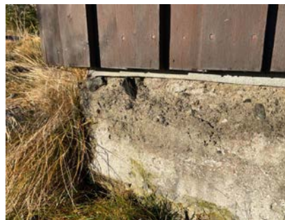
Forvitring av mur
