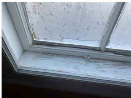
Vinduer er preget av elde
