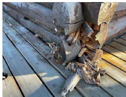
Råteskader i veggkonstruksjon
