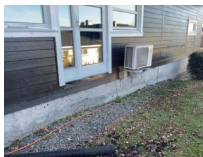
Mangler trapp, bulkete beslag under dør
